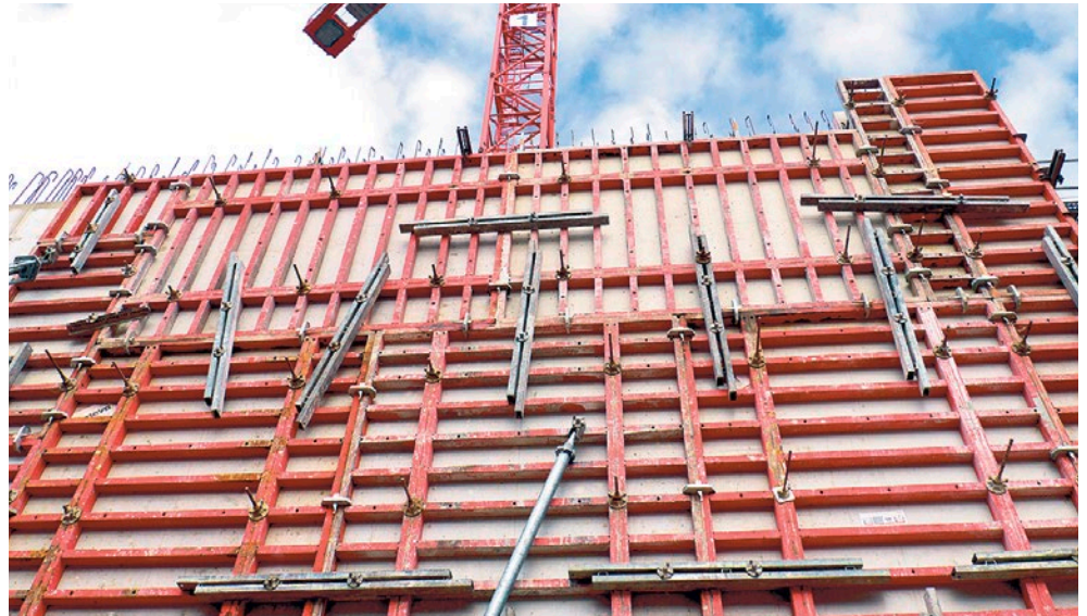
Il progresso avanza anche nel settore edilizio: sistemi di cassetta rapida e calcestruzzi autocompattanti consentono di gettare in tempi brevissimi muri alti diversi metri. Foto: www.meva.ch
